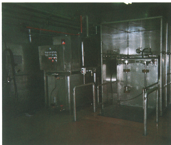
(本体及制御盤)
